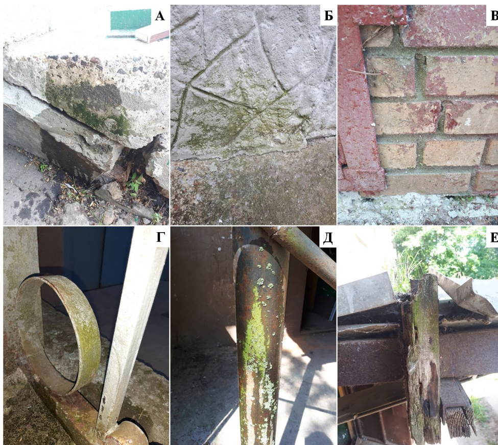
Рис.1. Места отбора образцов биопленок. А – ступеньки подъезда; Б – оштукатуренный цоколь жилого дома; В – кирпичная стена, шов; Г – низ металлической опоры козырька; Д – металлическая опора козырька; Е – деревянная опора козырька.
